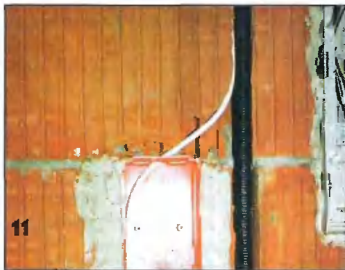
11 Здесь в одном отдельном кабельном канале проложены слаботочный кабель и телефонный провод.
