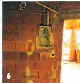
6 В распределительном щитке сосредоточены все провода разводки.
